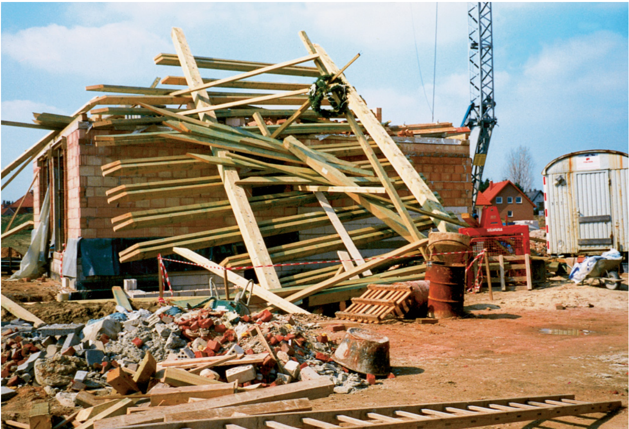
Sturmschaden am Dachstuhl
